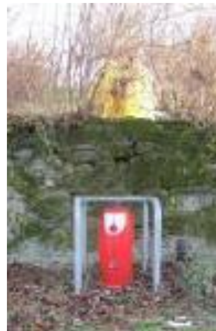
Poteau d'Incendie VB-6.1 situé à Villy-le-Bouveret
